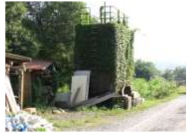
48 農業用水分水塔
