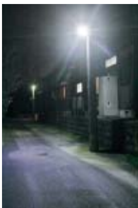
▲集落内のLED防犯灯
