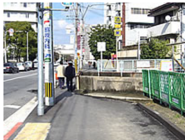
歩道幅員が確保されていない
