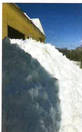
屋根から落ちた雪で湯田まちづくりセンター調理室東側の窓が塞がれた様子
