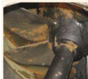
ポンプ設備のインペラ
