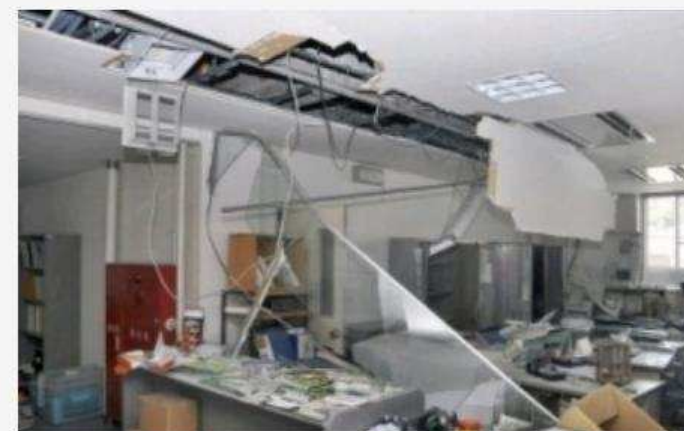
天井や壁が剥がれ落ちた大津町役場3階の総務課＝19日、熊本県大津町（撮影・梅本邦明）
