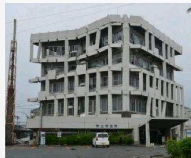
損壊した宇土市役所は4階部分がつぶれるなど地震の爪痕が生々しく残る＝23日、熊本県宇土市（撮影・前田倫之）
