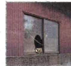
窓が割れた管理不全空家
