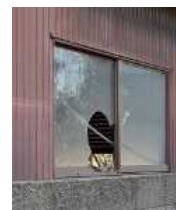
窓が割れた 管理不全空家
