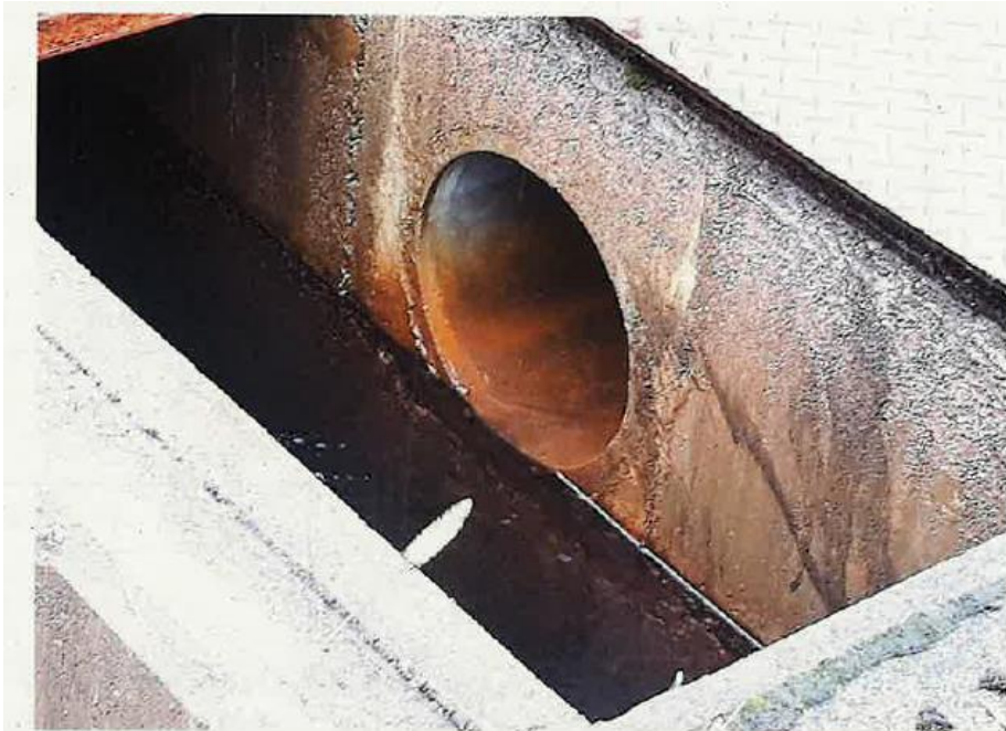
法定外公共物占用許可箇所 油分離槽 雨水排水 雨水排水 管
