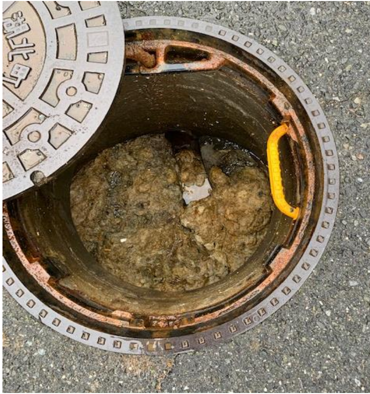
異物混入により詰まったマンホール
