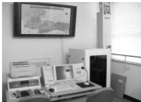
同報系防災行政無線操作卓
