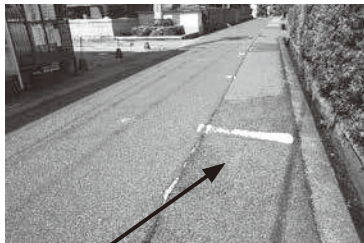
陥没箇所 1 m × 0.5 m
