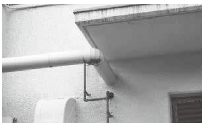
老朽化するパイプ
