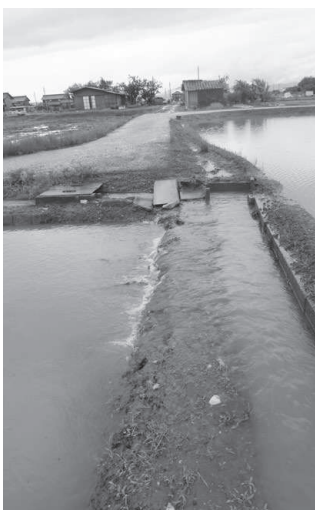
大雨により「内水氾濫」した地域
