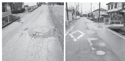
道路のひび割れや陥没
