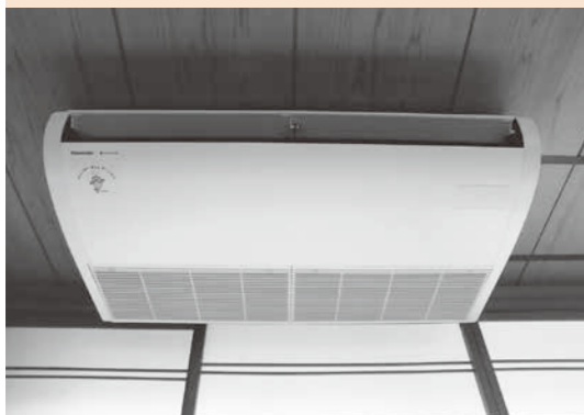
▲自治会館の空調設備
