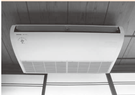
▲自治会館の空調設備
