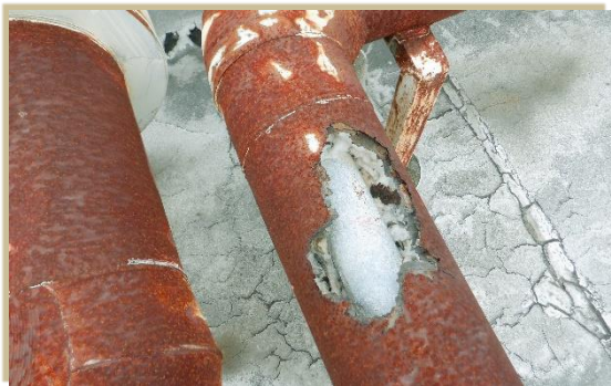
機械設備の劣化状況
