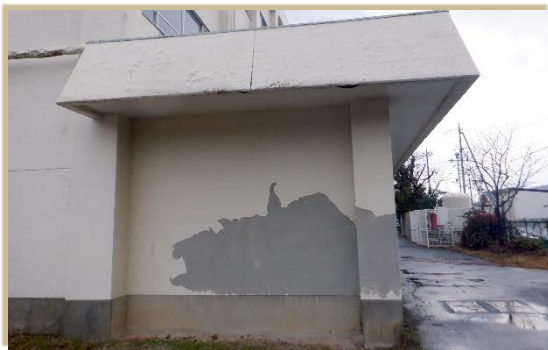
校舎外壁の劣化状況
