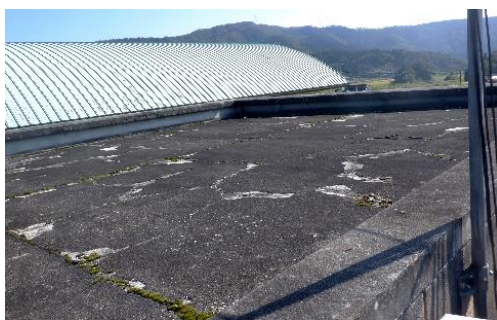
屋根・屋上の劣化状況
