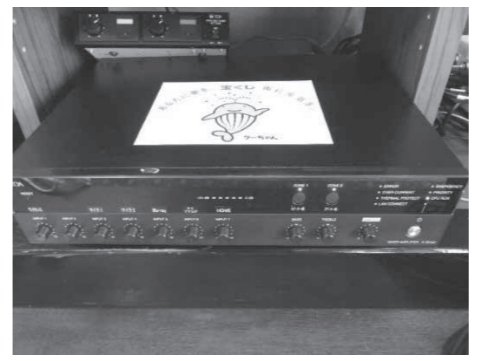
▲音響設備 (下八木自治会)
