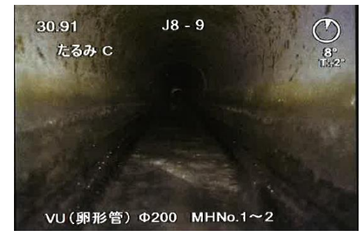
写真：管路内の様子
