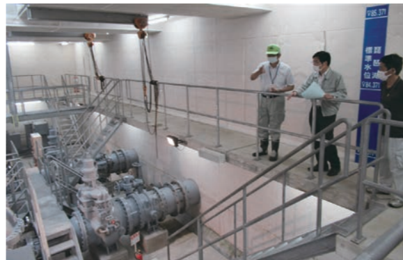
▲余呉湖補給揚水機(木之本町飯浦)
