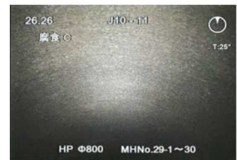
管内拡大画像(上部)
