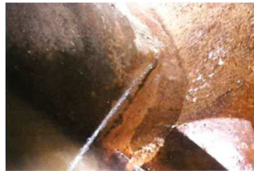
上流管口 侵入水
