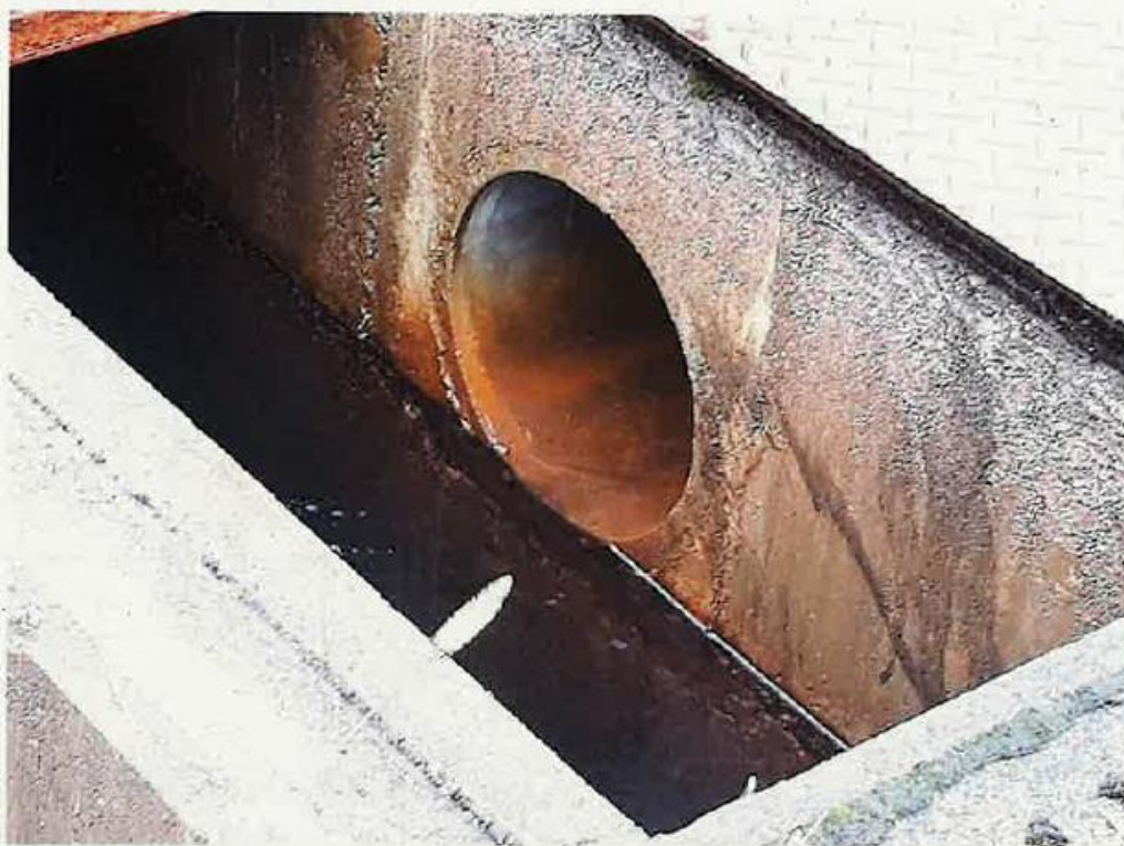
油分離槽 雨水排水管
