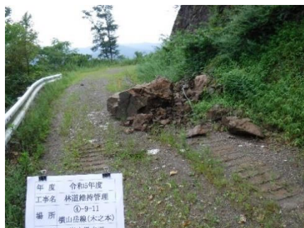
崩土（落石等）発生
