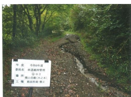
路面洗堀発生
