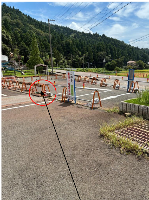
今回破損箇所
