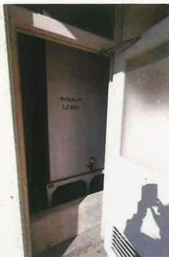
オイルタンク（重油）
