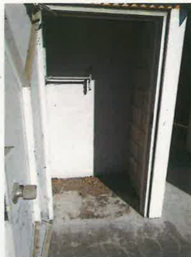
ガスボンベ置場
