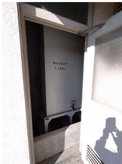
オイルタンク（重油）
