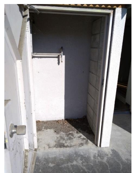
ガスボンベ置場
