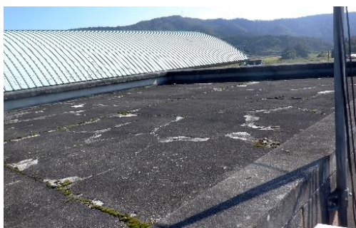
屋根・屋上の劣化状況
