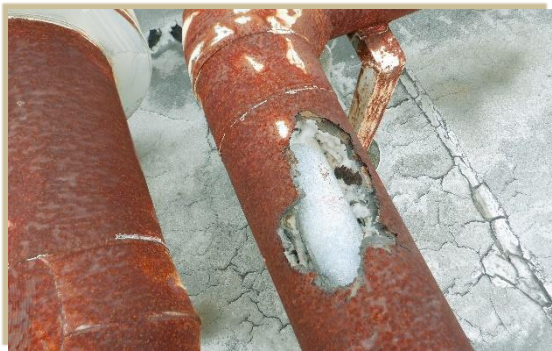
機械設備の劣化状況
