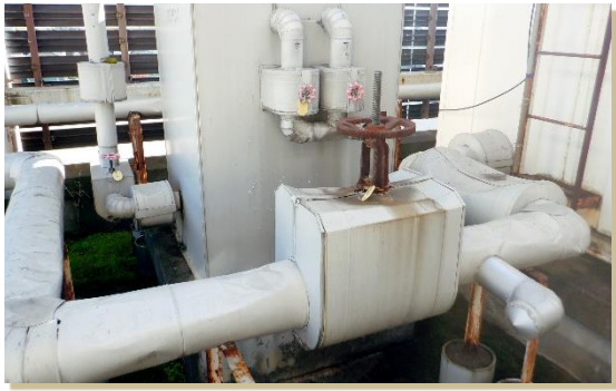
機械設備の劣化状況
