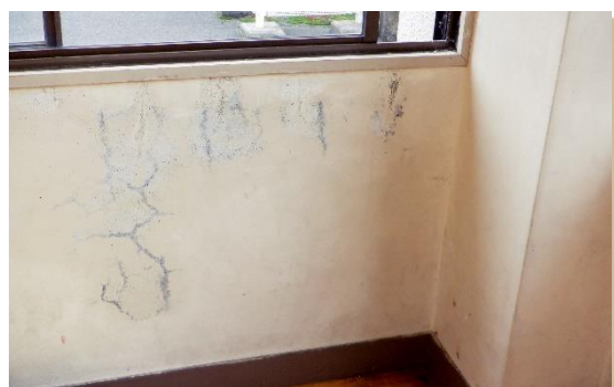
校舎内壁の劣化状況
